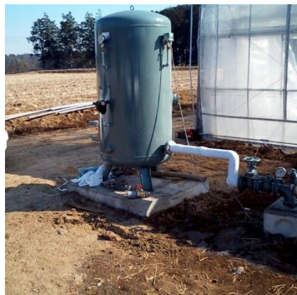
圧カタンク(ポンプ)
