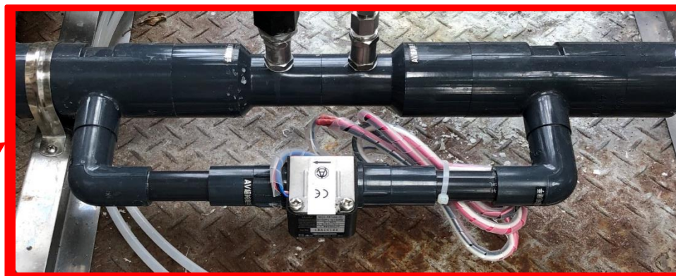
主配管と原水水量センサー
