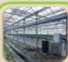
液肥投入機&付帯設備
